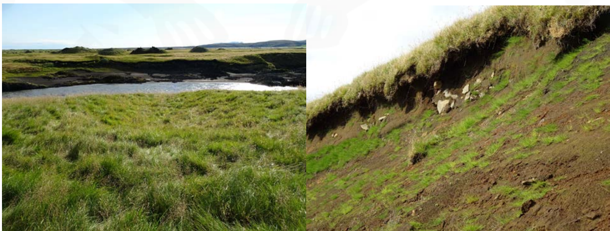
Tóft útihúss SF-174:018. Á mynd til vinstri er horft til suðvesturs en til norðurs á mynd til hægri þar sem sést í rofasárið þar sem suðurendi útihússins er að brotna í Eldvatnið
