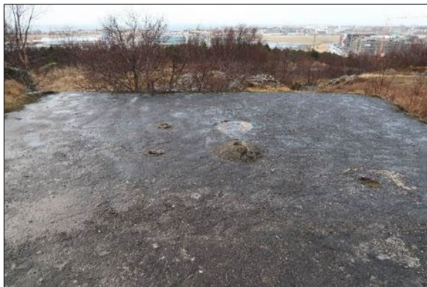
Mynd 137. Fimm göt eða sívöl för á flötu þakinu. Fyrir miðju er keilulaga uppsteypa í kringum eitt.
