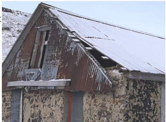
Mynd 8: Nærmynd af suðvesturgaflinum í febrúar 2020. Þakið er sigið út fyrir veggina og gaflinn að gliðna og losna frá. (Ljósm. ÓLA)
