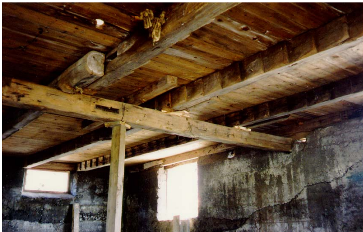
Mynd 19. Baldurshagi/Sólvík/Vilhelmshús, loftbitar í kjallara hússins, myndin tekin 1989, þegar viðgerð var að hefjast, myndin tekin frá austri til vesturs. Ljós. Sigríður Sigurðardóttir 1989
